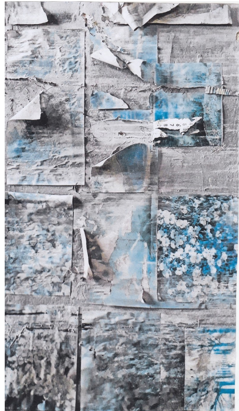
Eroded wall in Põhjala Tehas Photo diary
